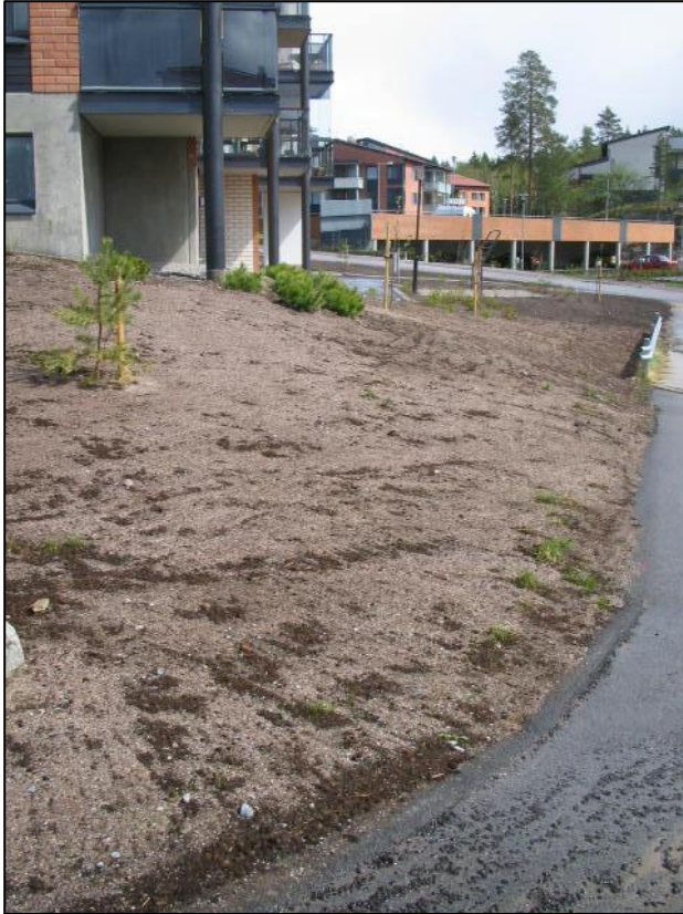
Suojaamattomien maapintojen eroosio
